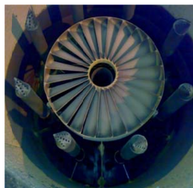
شکل ۲ تصویر نازل پاشش سوخت، کانال ورود هوا و تجهیزات نصب شده در آن
